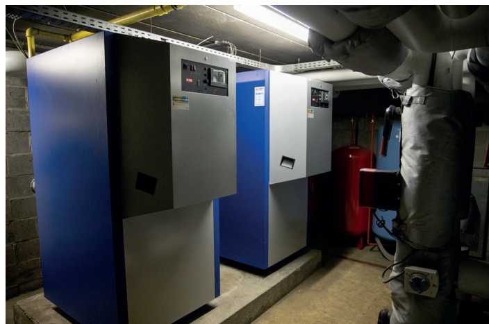
Lorsque la corrosion des systèmes de chauffage central se traduit par des problèmes techniques manifestes, les composants concernés doivent être remplacés.
