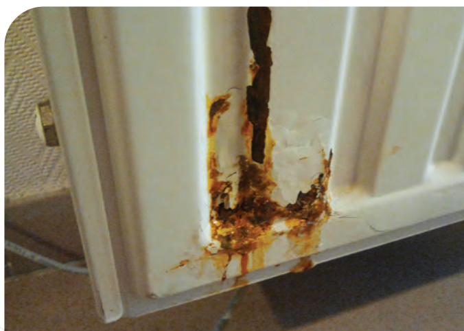
Fig.1 - Lek als gevolg van een doorboring te wijten aan de corrosie van een stalen radiatorwand
