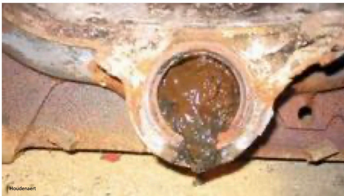
1 | Afzettingen ten gevolge van corrosie in een centraleverwarmingsinstallatie.
