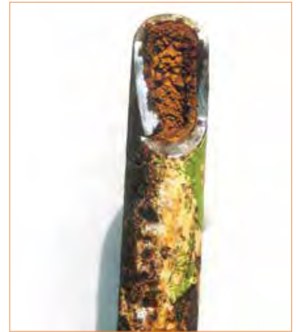
Corrosie kan aanzienlijke schade veroorzaken aan leidingen of pompen.
