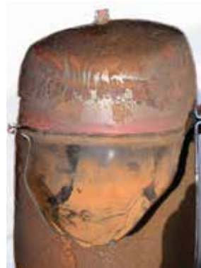
Doorsnede van een expansievat met afzetting van corrosieslib op het membraan.
