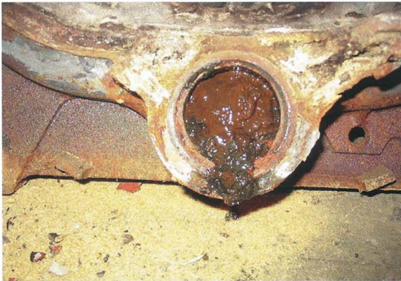
Afzettingen in een verwarmingsinstallatie.
