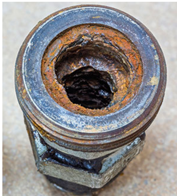
4 | Dépôts d'oxyde de fer dans les canalisations
