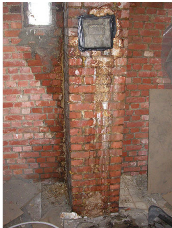
1 et 2 | Apparition de taches d'humidité dans un parachevènement intérieur et le long d'un conduit de fumée
