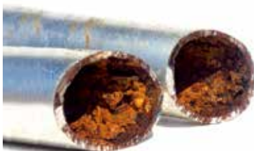
Corrosie en kalkaanslag zijn aantastingen die pas na jaren zichtbaar worden.
